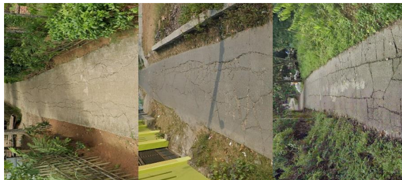
Gambar 3 Tipe Kerusakan pada Perkerasan Eksisting
