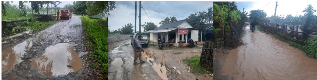
Gambar 5 Kondisi Perkerasan Paving Block di Jl. Pantai Bahagia
